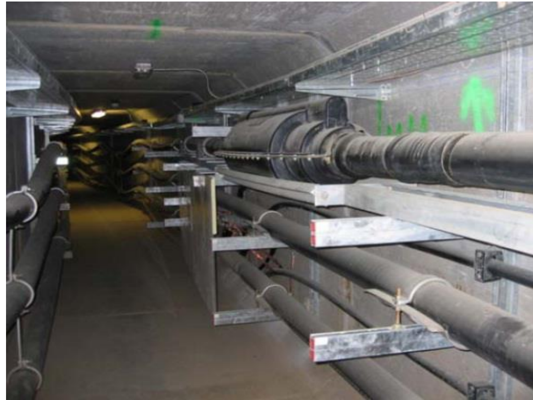
380-kV-VPE-Kabelanlage in Madrid, Quelle: Amprion
