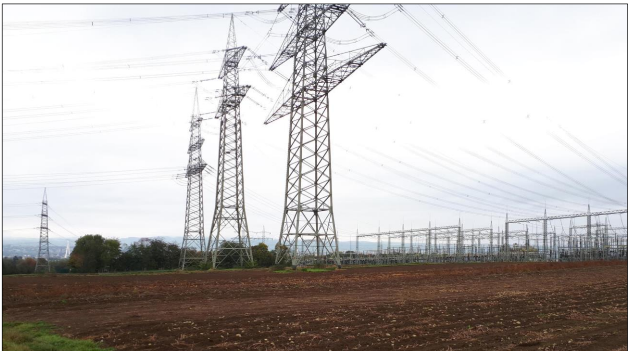
Foto 50: Die Umspannanlage Weißenthurm liegt in einem Mosaik aus Ackerflächen und intensiv genutzten Obstanbauflächen (382)
