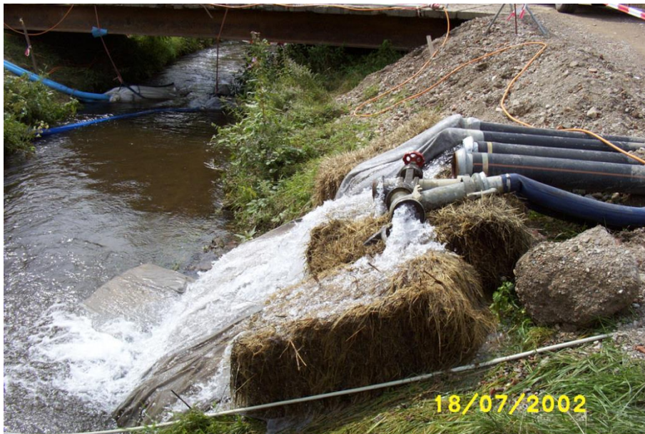
Abb. 17: Einleitung des geförderten Grundwassers in einen Vorfluter
