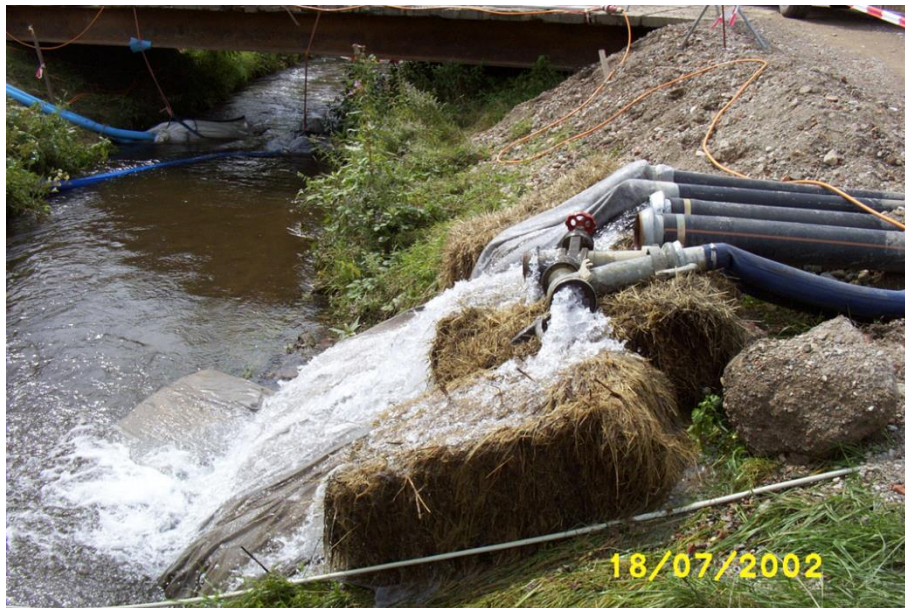
Abb. 17: Einleitung des geförderten Grundwassers in einen Vorfluter
