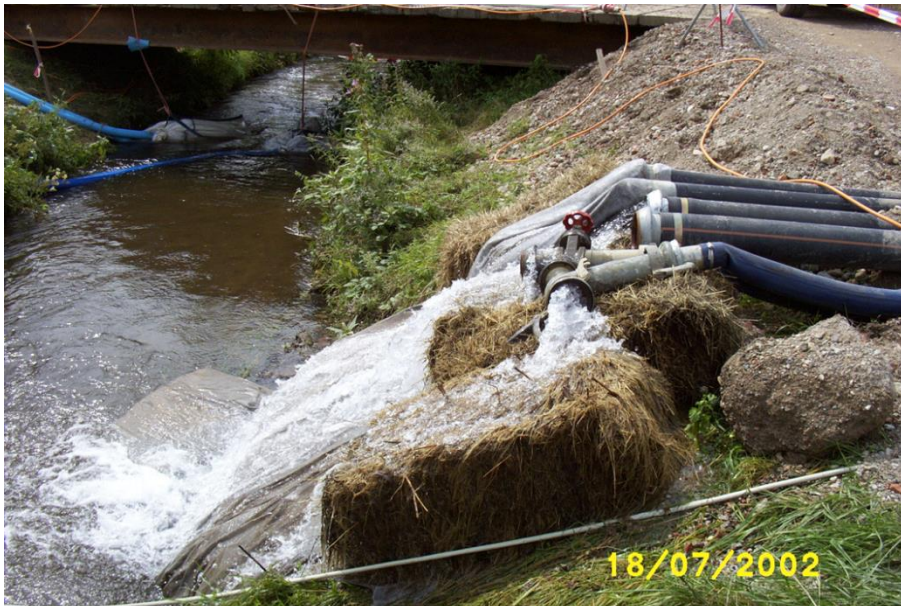
Abb. 17: Einleitung des geförderten Grundwassers in einen Vorfluter
