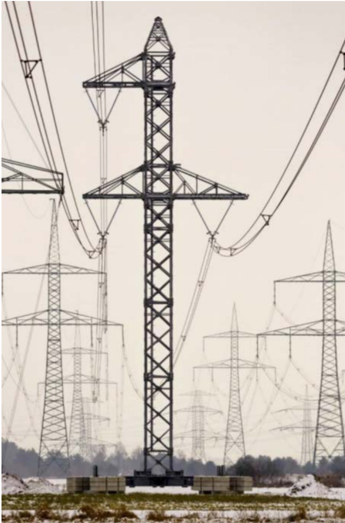
Abbildung 44: Beispiel für ein Auflastprovisorium
