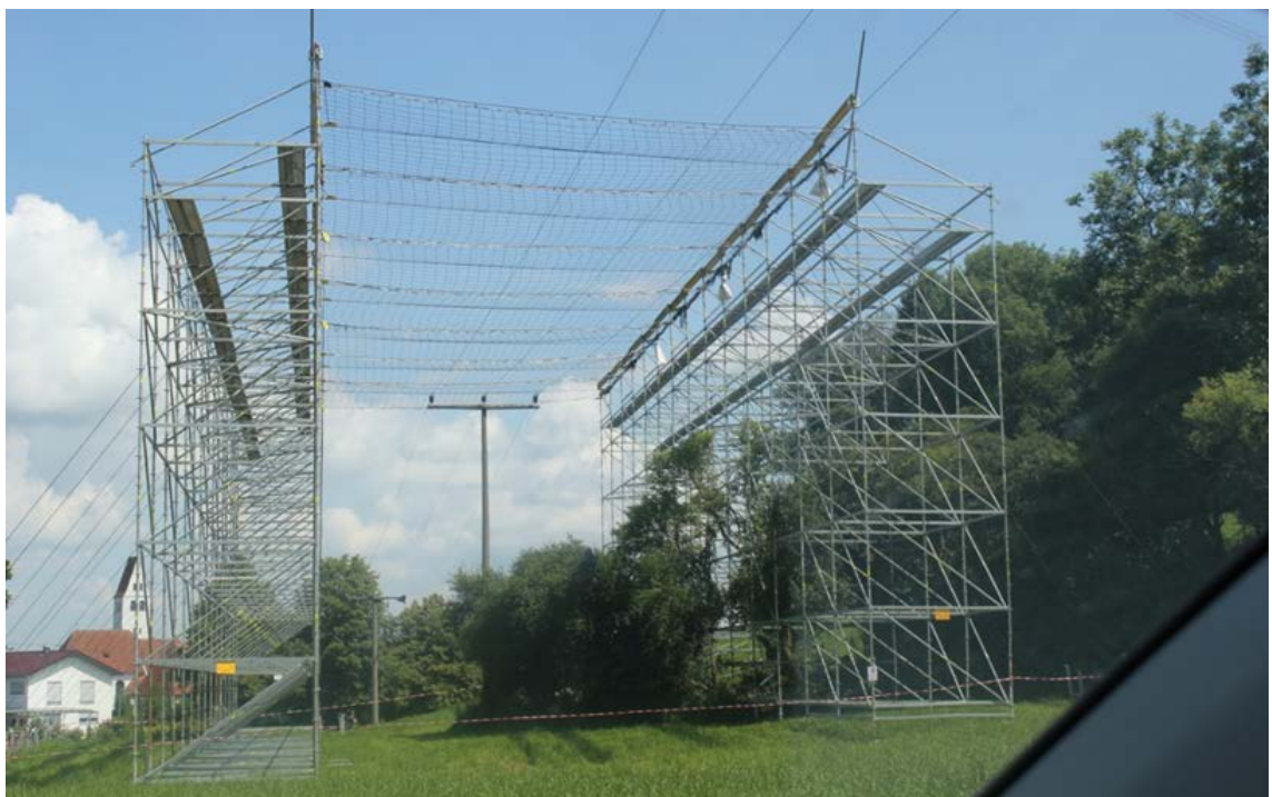
Abbildung 43: Schutzgerüst über Niederspannungsleitung
