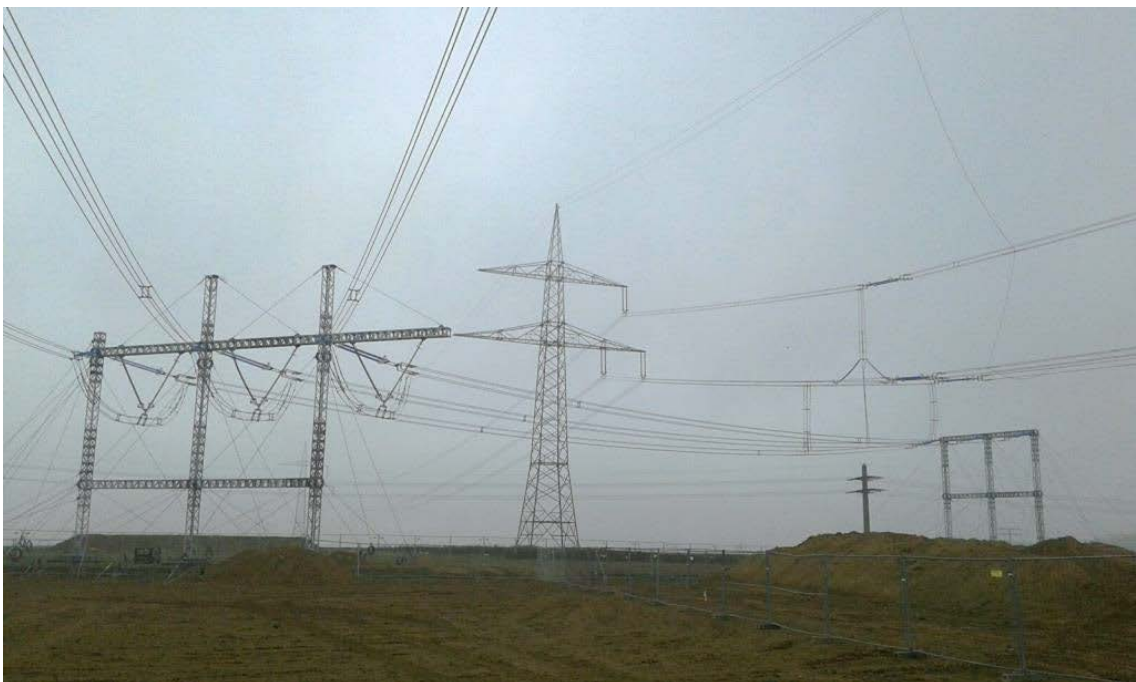
Abbildung 48: Beispiel für ein Provisorium mit Abankerung
