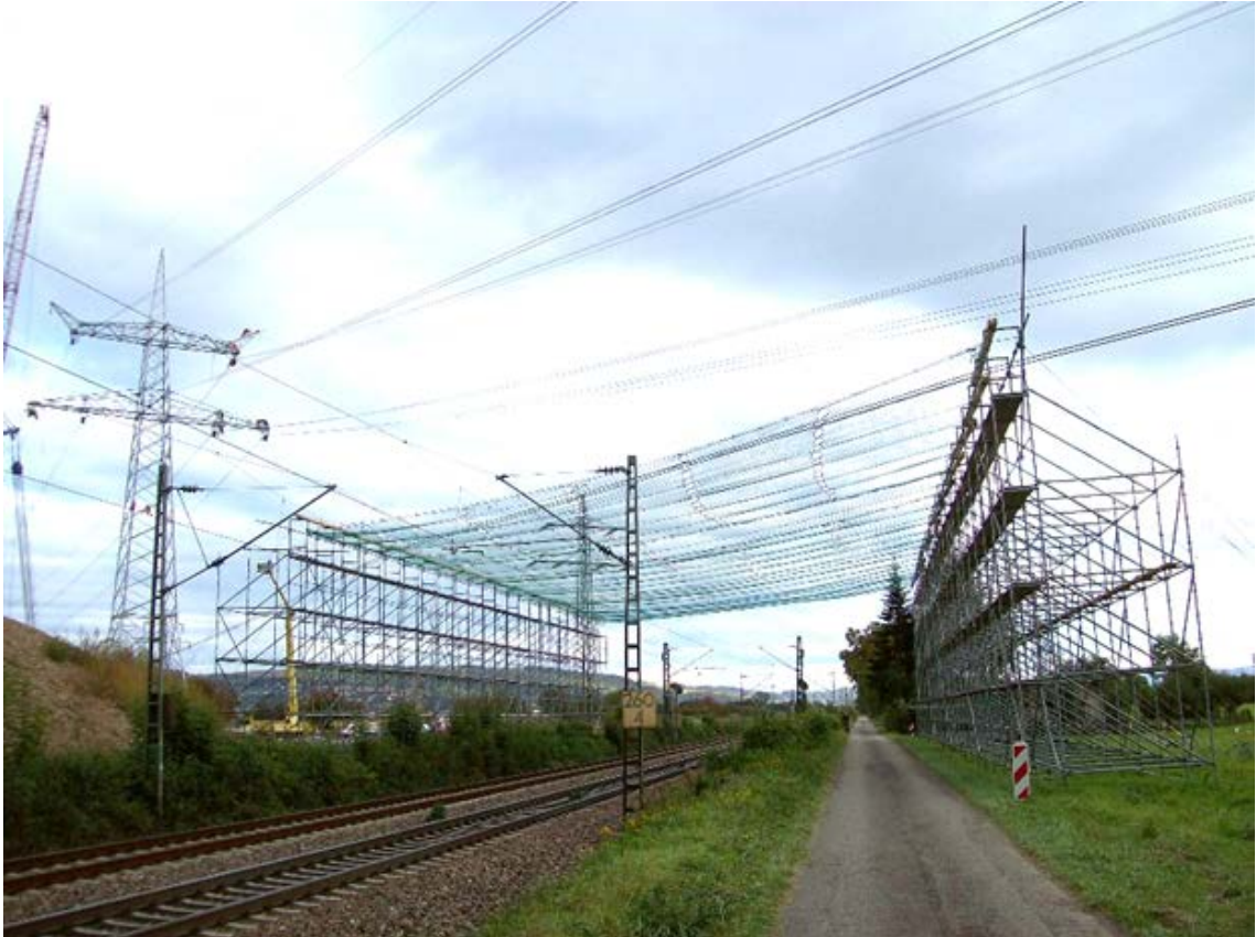
Abbildung 44: Schutzgerüst über Bahntrasse
