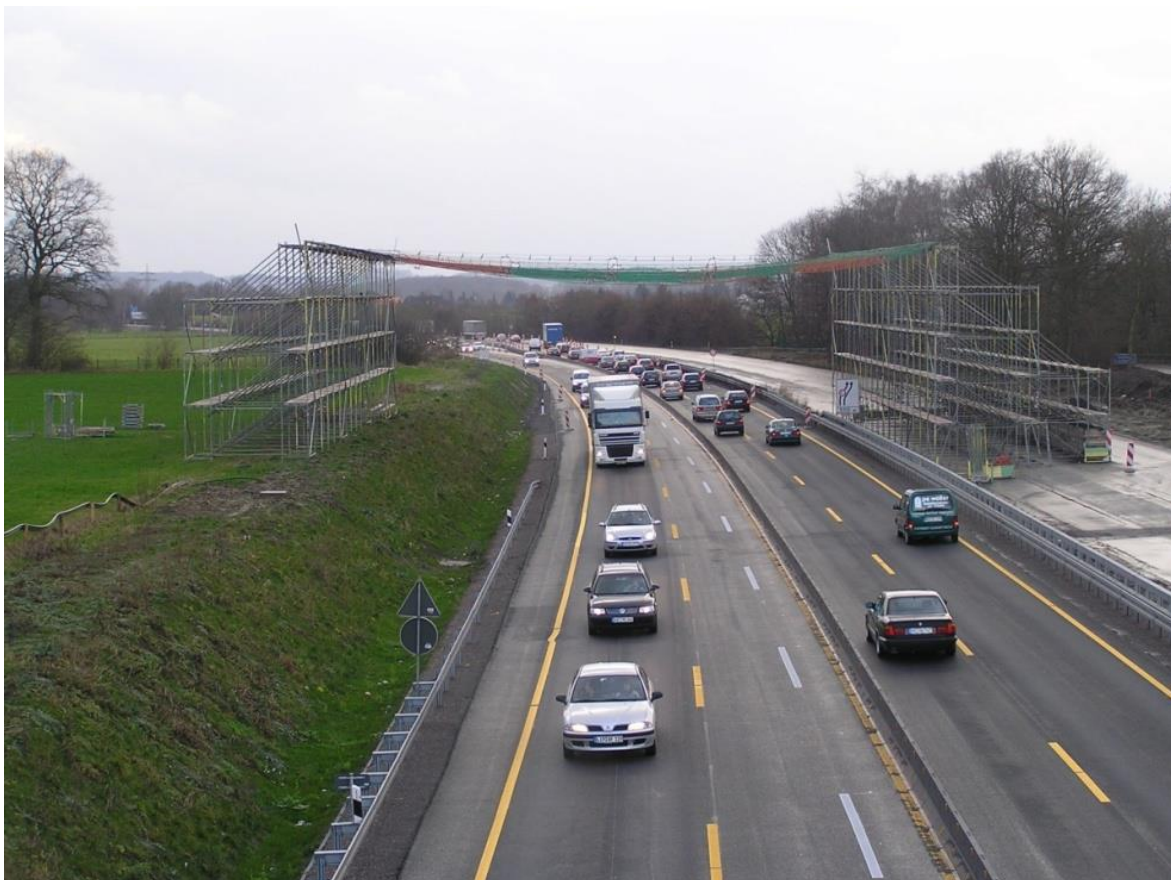
Abbildung 15: Stahlrohrschutzkonstruktion mit Netz über einer Autobahn
